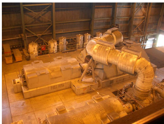
Generátory parnej turbíny tepelnej elektrárne. (Zdroj: http://en.wikipedia.org/wiki/Power_station ).
